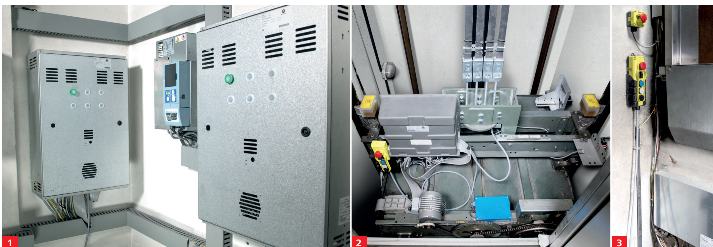
1 : Salle des machines | 2 : Toit de la cabine | 3 : Cuvette de la gaine d'ascenseur
